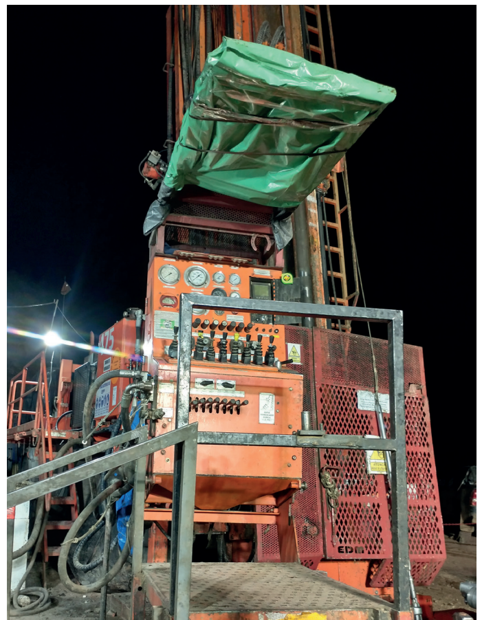
Área de comando del equipo de perforación.
