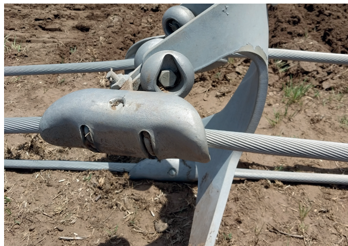
Yugo de suspensión deteriorado
