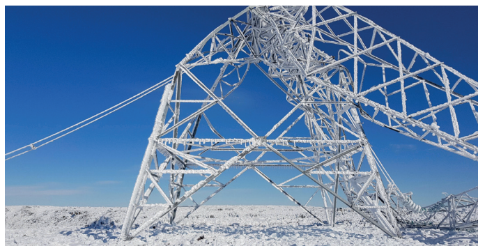
Colapso de línea eléctrica
