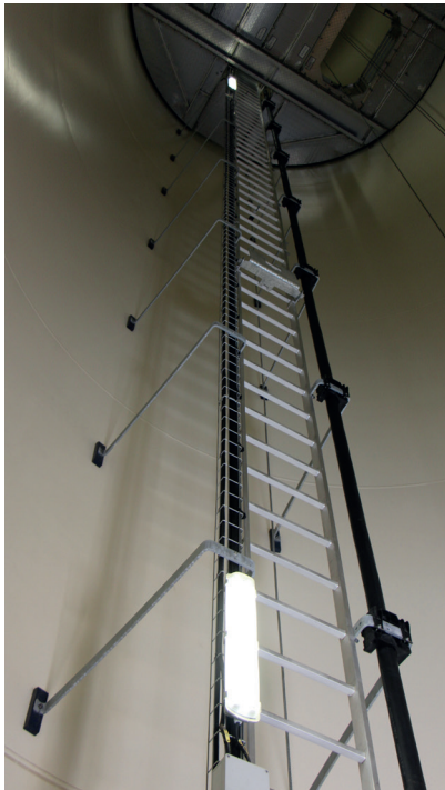
Escalera con línea de vida
