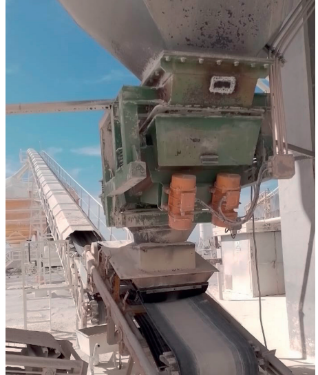
Descarga: Automática. Cinta transportadora con confinador de polvos que alimenta tolva de almacenamiento.
