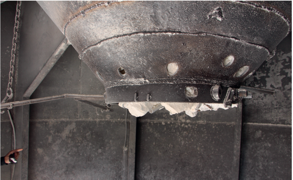
Descarga de horno de lecho mixto
