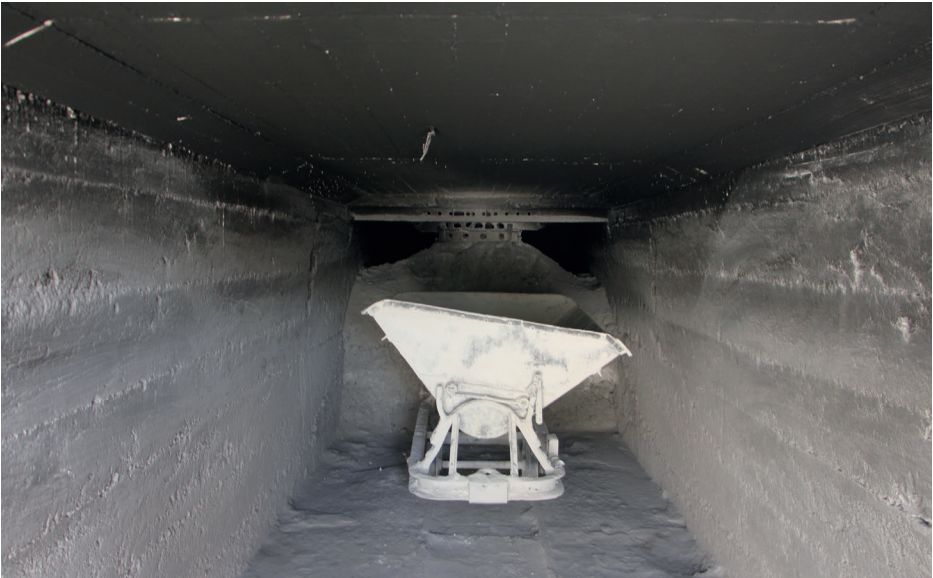
Zona de descarga de horno de lecho mixto
