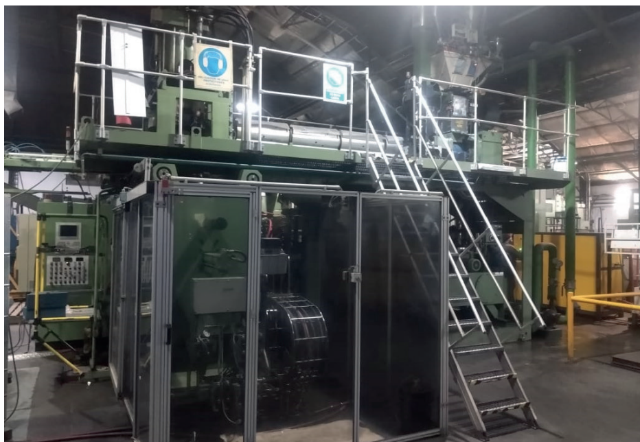
Sector de máquinas, compresores y tableros generales
