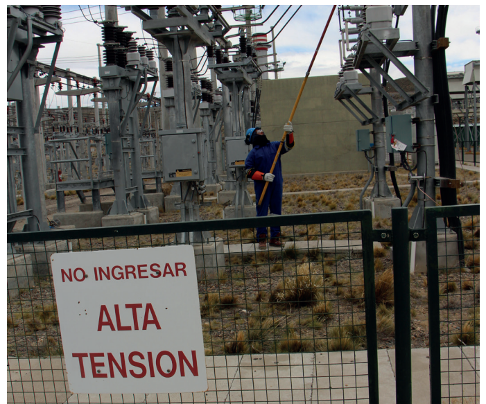
Detención de ausencia de tensión.
