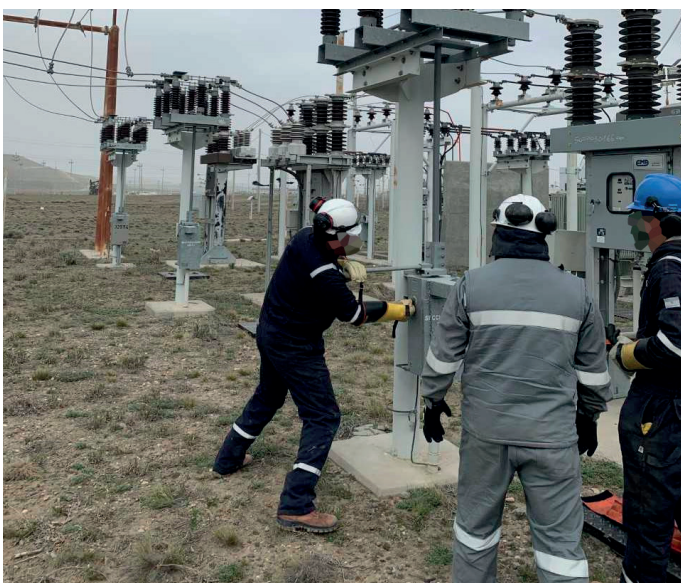
Corte visible de seccionador.
