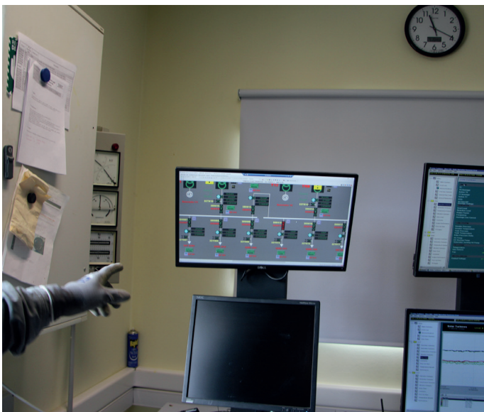
Verificación del bloqueo de comandos a distancia.
