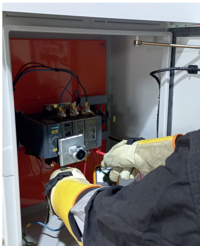
Trabajador realizando la medición de tensión en un conmutador.
