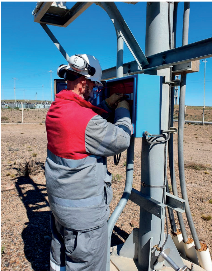
Bloqueo visible en un tablero de baja tensión.
