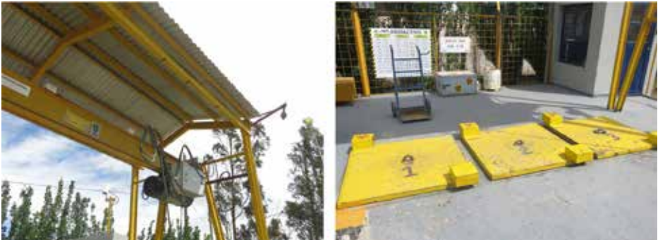
Dos tomas de un búnker de almacenamiento de fuentes y material radiactivo, donde pueden apreciarse el dosímetro de área y los fosos.
