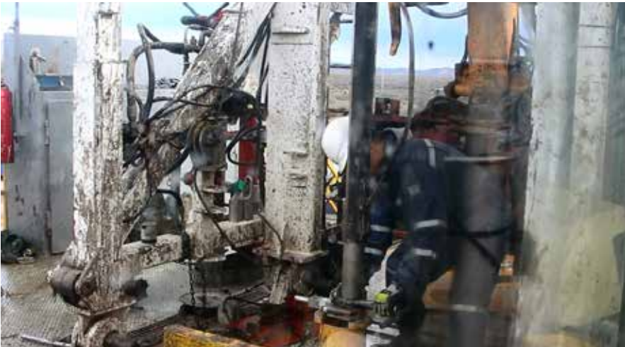
Maniobra de bajada y torque de caños en una boca de pozo, durante un perfilaje con fuente de neutrones.
