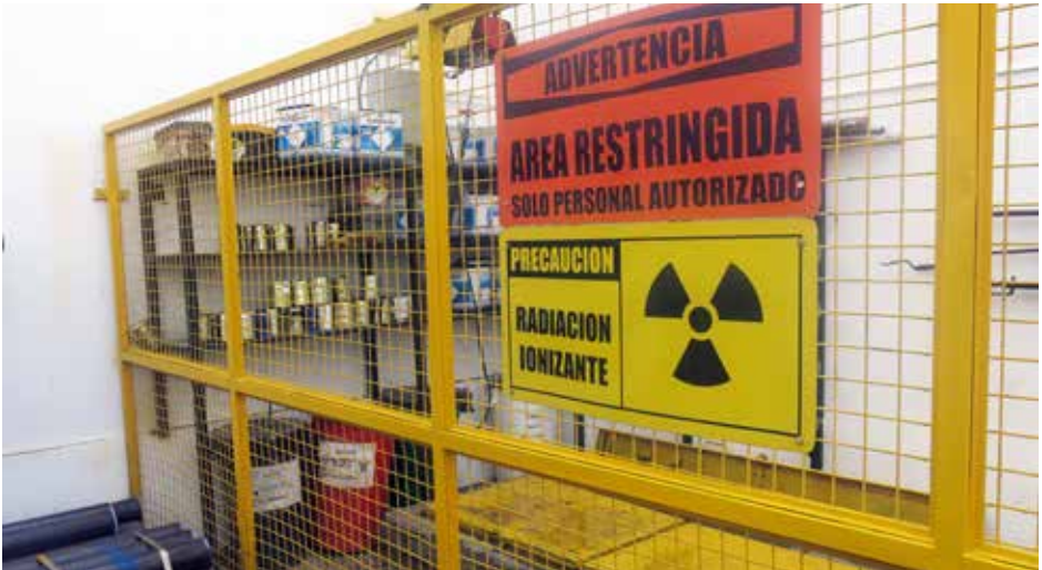
Bunker de base con cartelera restrictiva e identificatoria del riesgo radiológico, con zonas de almacenamiento para 131 I y fuentes selladas en fosos.
