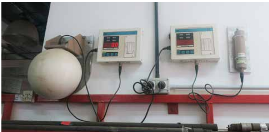
Dosímetros de área monitoreando los niveles de radiación ambientales en un taller de almacenamiento y mantenimiento de herramientas.
