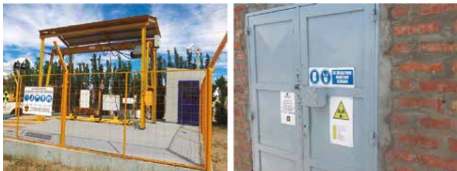
Vista de dos tipos de bunkers en las que se almacenan fuentes selladas y no selladas, en los que pueden observarse las restricciones perimetrales y la cartelería en la que identifica el riesgo radiológico y la obligatoriedad de uso de los elementos de protección personal.
