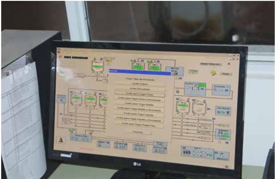
Automatización del proceso.
