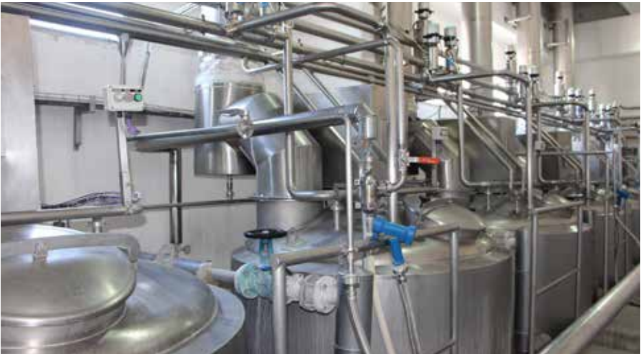
Tanques de almacenamiento.
