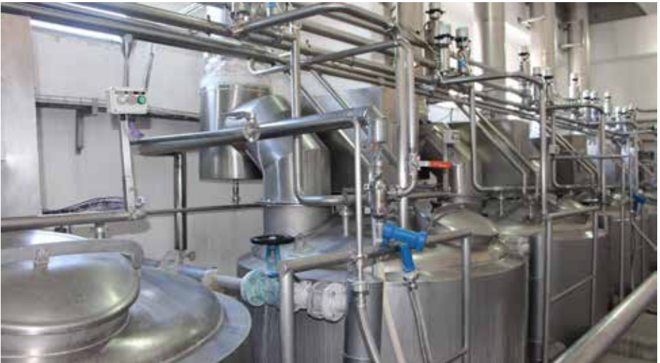
Tanques de almacenamiento.
