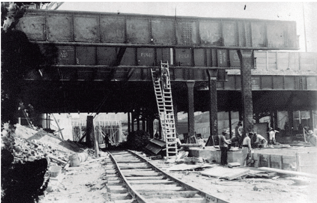
Vista de los trabajos de construcción de Estación Plaza Miserere, 1912. (Foto: CTAA, colección AGP)
