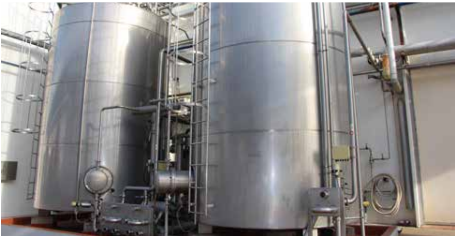
Tanques de almacenamiento de leche cruda. Fuente: SRT (2016)
