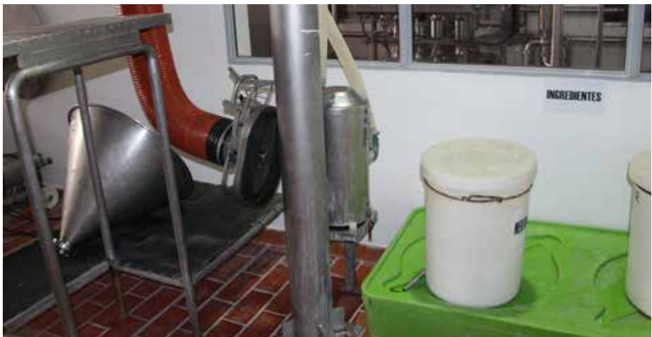
Agregado manual de ingredientes en tolvas de descarga. Fuente: SRT (2016)
