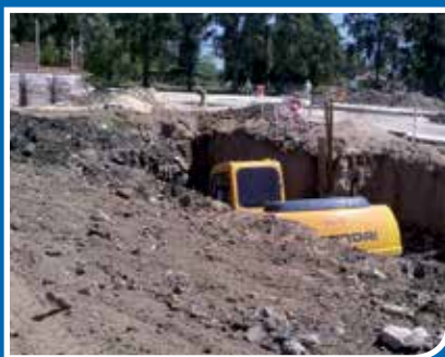
ANALISIS DE TRABAJO SEGURO | Riesgo de derrumbe de la excavación, suelo de relleno
