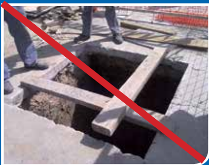
ASÍ NO | Falta de apuntalamiento, medios de izaje, medios de salida y barandas de protección.
