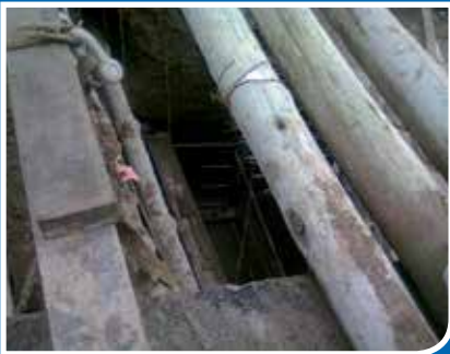
Soporte de instalaciones existentes.
