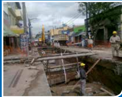
Soporte de instalaciones existentes.
