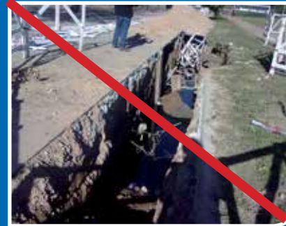
ASÍ NO | Apuntalamiento de excavaciones.
