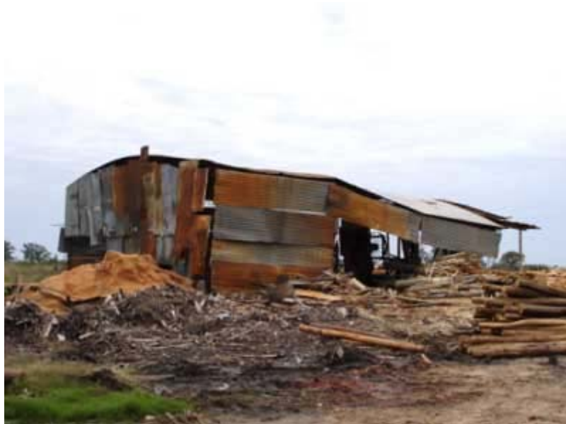
Foto N° 57: Estructura edilicia de precariedad extrema
