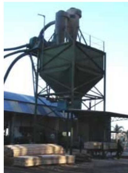
Foto N° 47: Ciclones y tolva
