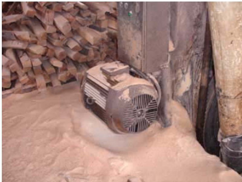
Foto N° 67: Motor rodeado y cubierto de aserrín
