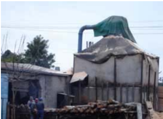
Foto N° 46: Ciclón y tolva sobrecargada
