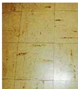
Suelos de vinilo-amianto.
