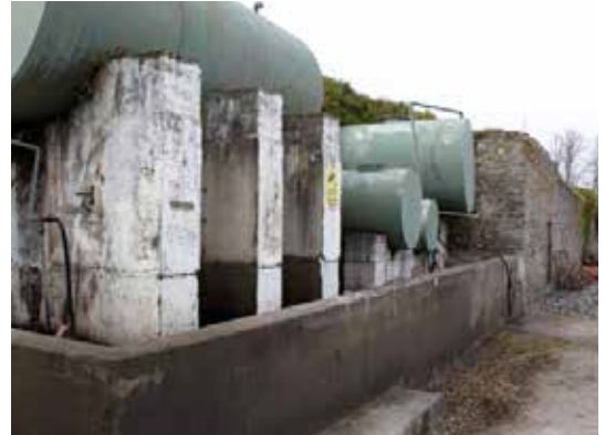
Almacene el combustible de manera segura.
