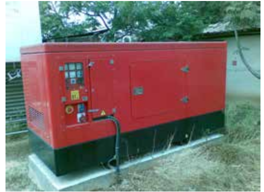
Mantenga los generadores en buenas condiciones.
