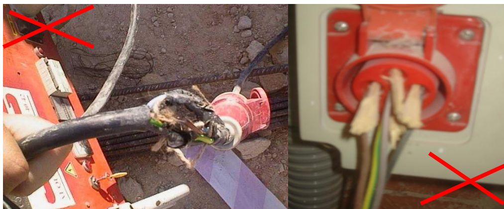
Situaciones inaceptables de falta de aislamiento eléctrico
